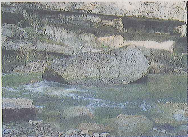
Un gros bloc rocheux s'est détaché de la paroi, faisant dévier le courant de la Valserine vers la base d'une des piles du viaduc.
