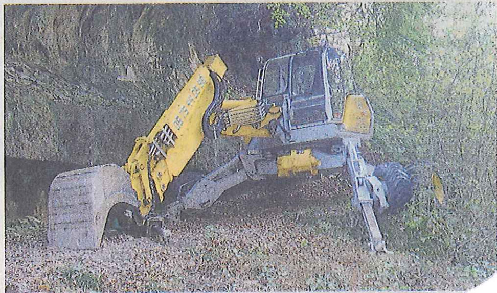
Déposé dans le lit du fleuve, l'engin a eu tout le loisir de dégager l'éboulement, puis de renforcer l'embase de la pile du pont. La mission s'est achevée le 6 novembre.
